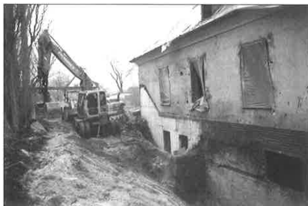
Im Oktober begannen die Bauarbeiten in der ehemaligen "Waffenmeisterei", die zum Besucherinformationszentrum ausgebaut wird.
